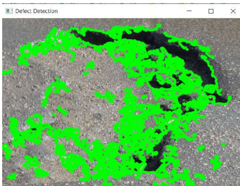
Рис. 3. Контура неровностей дорожного покрытия
